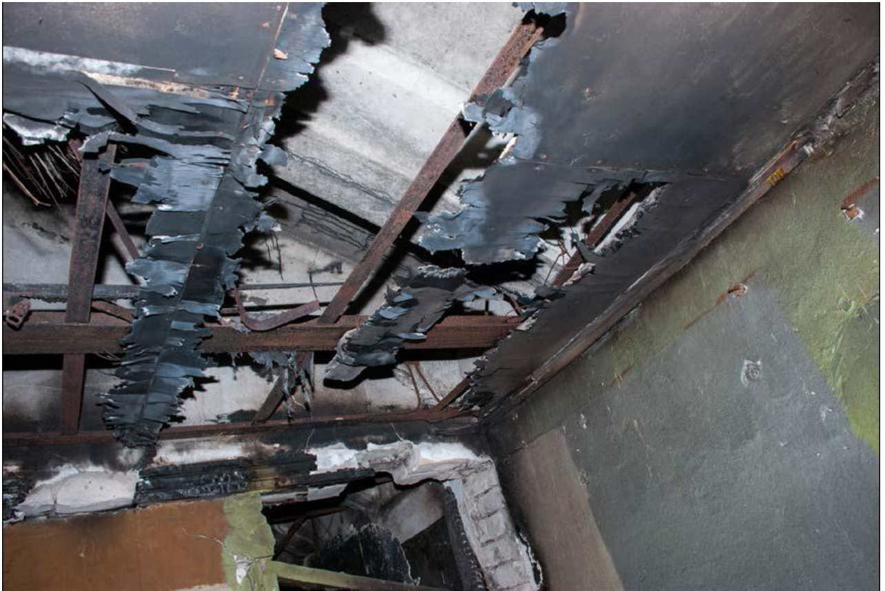
Foto 17. KP sisevaade. Põlenud vineerlagi. Foto Mart Mõniste 27.09.2013.
