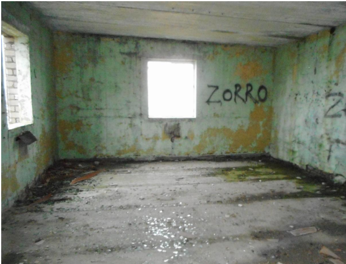
Foto 19. Komplekshoone II korruse suurema ruumi sisevaade (8.11.2017). Akende all olid kalorifeerid, parempoolse seina ääres 2 radarioperaatorite töökohta. Laes on mõned lekkekohad.
