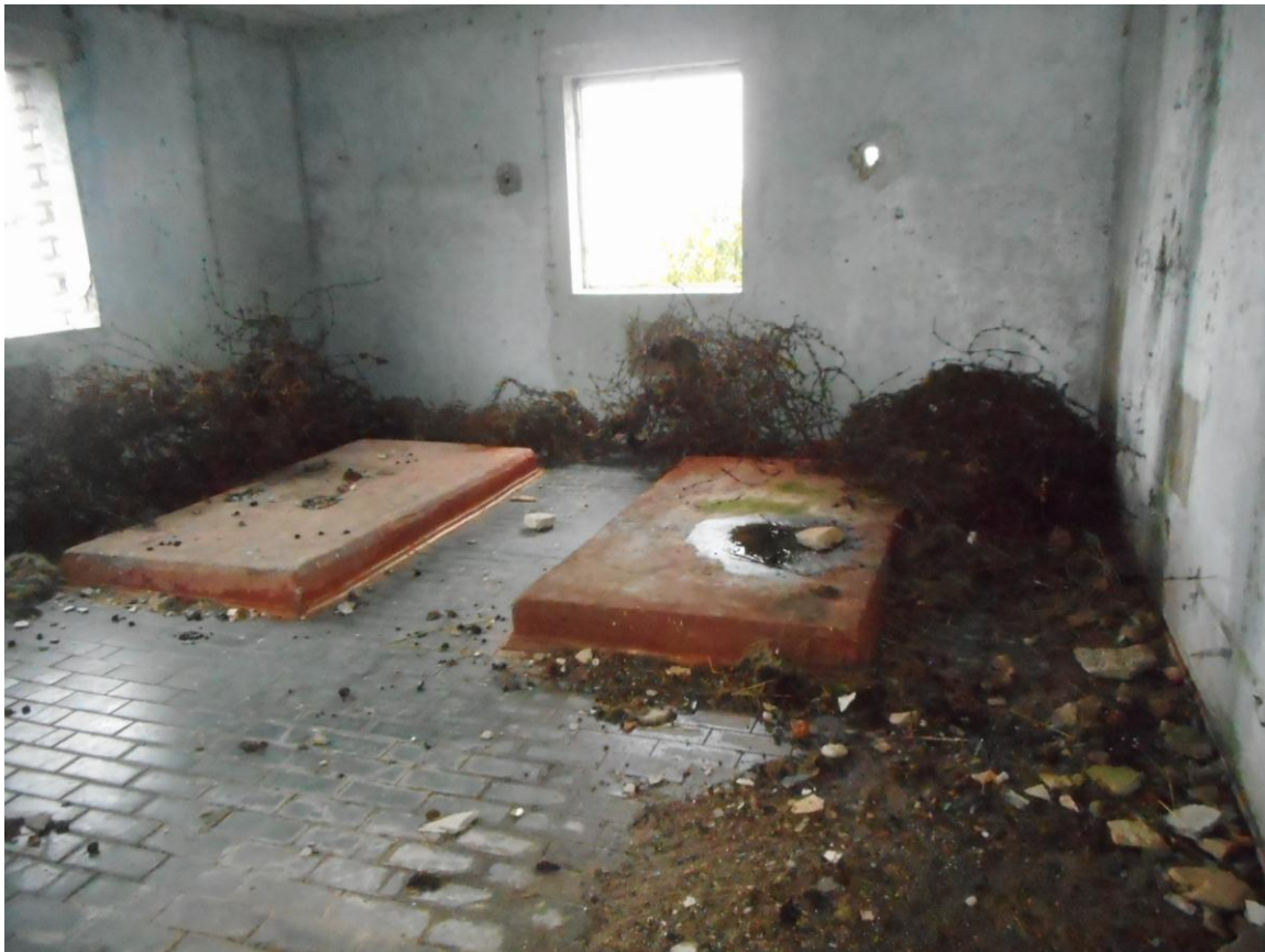
Foto 17. Diisliruum betoonalustega (7.10.2017). Glasuurplaatidega kaetud põrand on reostatud lambasõnnikuga. Keegi on ruumi kogunud roostes piirdeaiatraati ja hiina kalavõrke.
