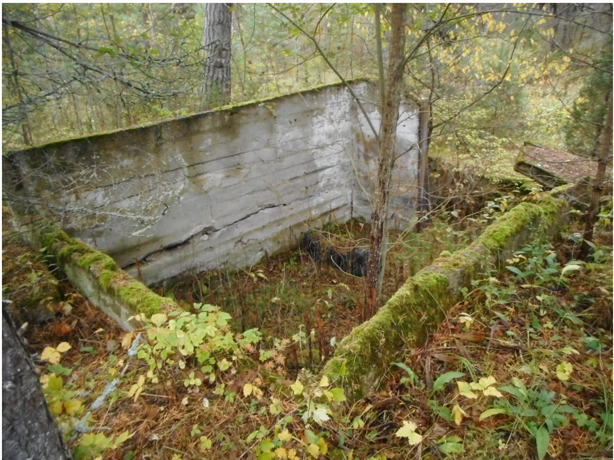
Foto 31. Kütusehoidla (joonis 4, nr 6) vaade edelast, tagaseina poolt (7.10.2017). Betoonseinte paksus on u 15–20 cm ja kagupoolne sein on ära murdunud. Tagasein on teistest u 0,5 m madalam. Hoone on rajatud kuni 1 m sügavusele maasse, sissekäigul on betoontrepp. Sees komplekt betoonist vaodialuseid. Hoonet ümbritses nelja silikaatkivist postiga eraldi okastrataed.
