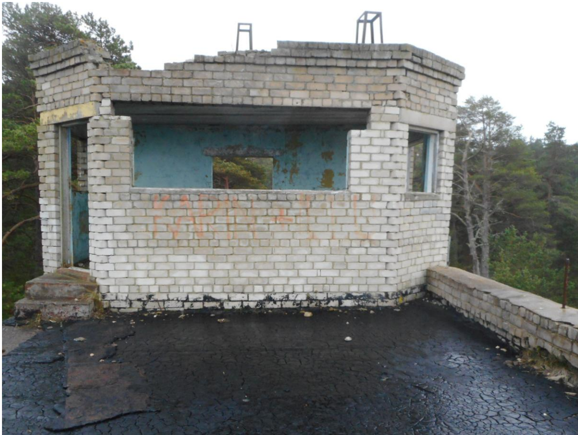
Foto 21. Visuaalvaatlusruum mere poolt (8.11.2017). Kadunud on vaatlusruumi keskmise akna betoonsillus. Katust/rõdu ääristanud armatuurrauaast piirdepostid on alles.
