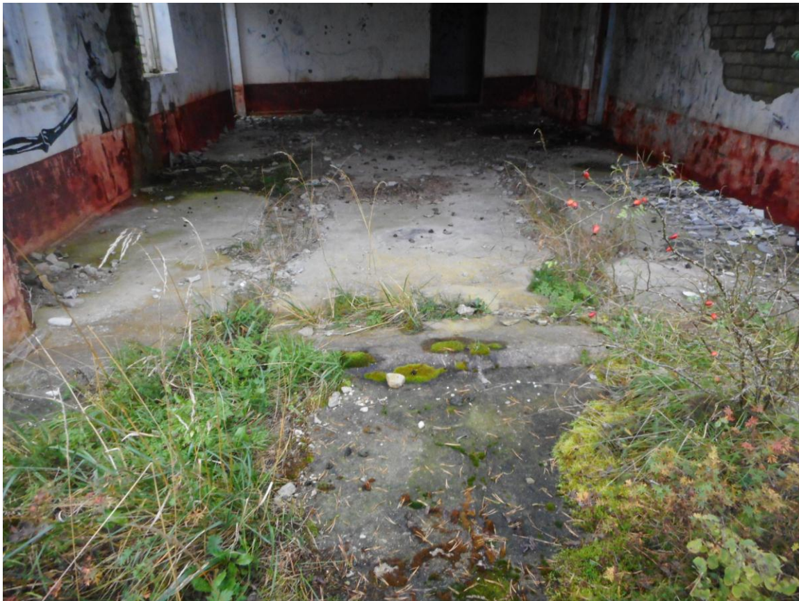
Foto 13. Prožektoriruum (7.10.2017). Relsid on välja kistud, parempoolsel seinal on u 1/4 ulatuses veekahjustused (vetikad, osa krohvi maha langenud). Tagaseinas ukseava, mille taga on veel kaks väikest ruumi.
