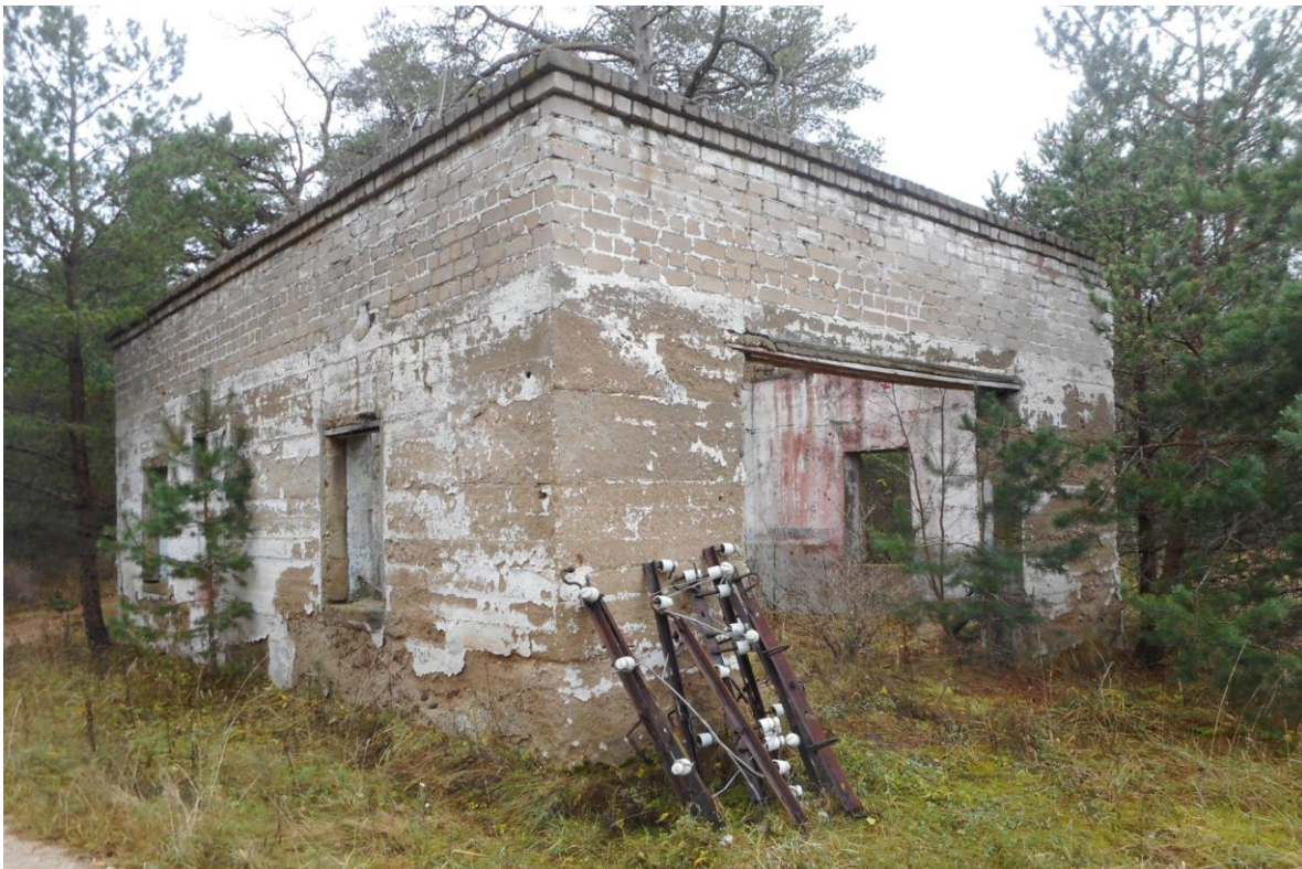
Foto 25. Vana diislihoone (joonis 4, nr 2) (7.10.2017). Betoonist valatud seinad on laotud u 1,1 m kõrgemaks. Ukseava laius on u 3,5 m, kõrgus u 2 m ja selle ees on lühike betoneeritud kallak – peale uue komplekshoone valmimist võib hoone olla ümber ehitatud UAZiku garaažiks.
