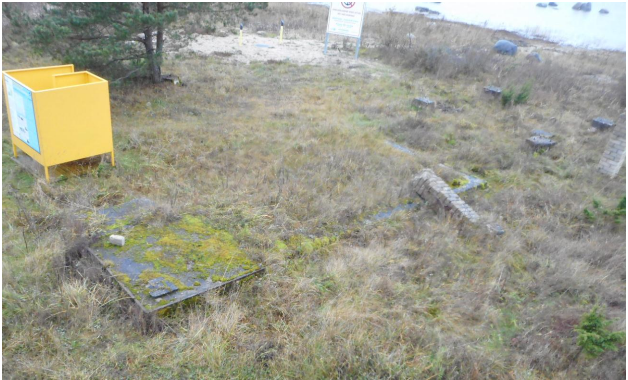
Foto 30. Vana operaatorihoone vundament (joonis 4, nr 5) (8.11.2017). Üks külg on lammutatud. Vasakul oli betoneeritud lahtine sissepääsuesik u 40x40 cm nurgakandepostiga.
