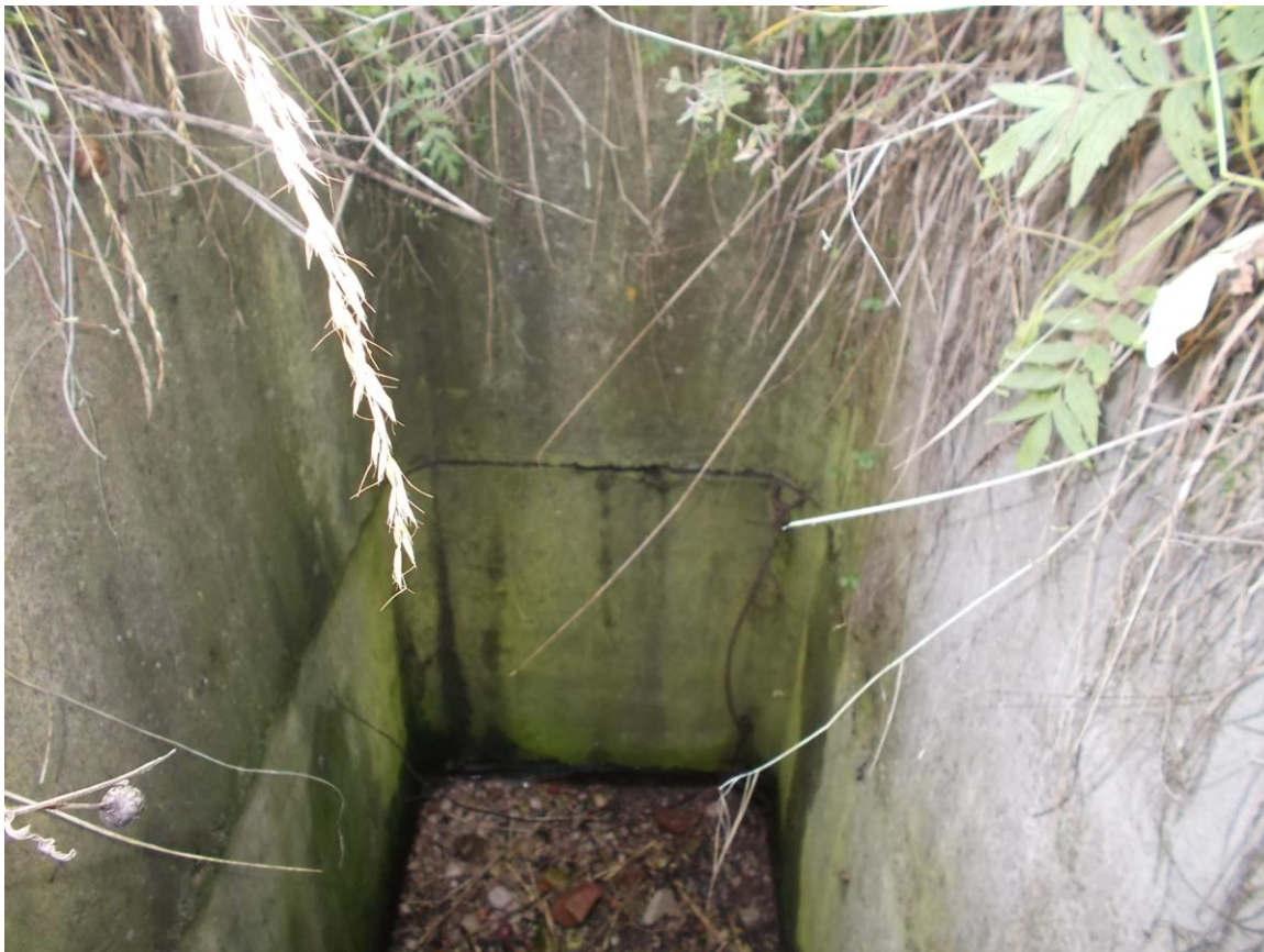
Foto 12. Arvatav drenaažikaev (u 3x1x3 m) hoidla kirdeküljel, standardsetest betoonelementidest, pealt kaetud puuredeliga.
