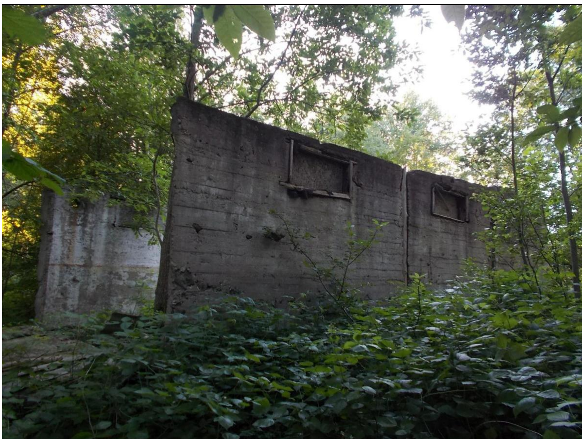
Foto 27. Remondikanaliga? betoonboks [75]. Lõunapoolne otsasein on maha langenud.
