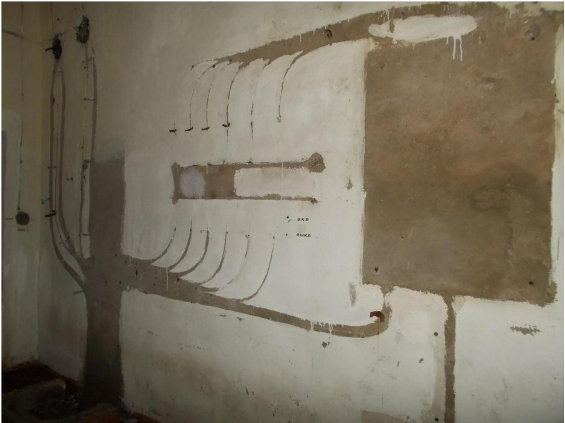
Foto 16. Hoidla [62] kliimabloki elektrikilbiruumi seinal on selline „juhtmepuu“.
