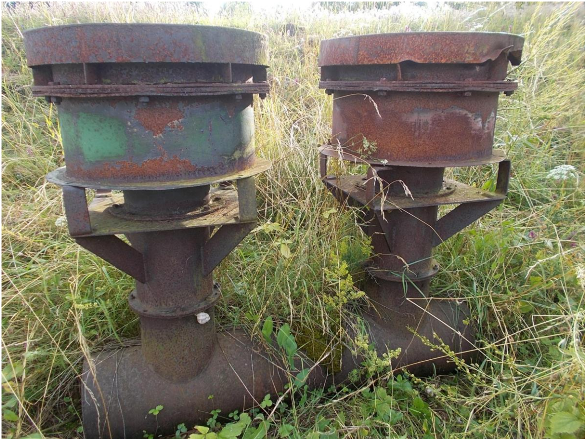
Foto 11. Hoidla [62] ventilatsioonitsikud ehitise lael.
