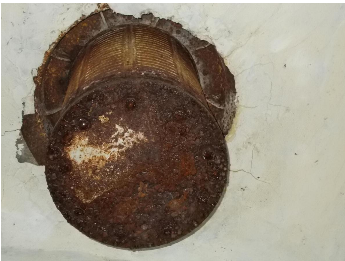
Foto 15. Õhufilter hoidla [62] kliimabloki ventilatsiooniruumi laes.
