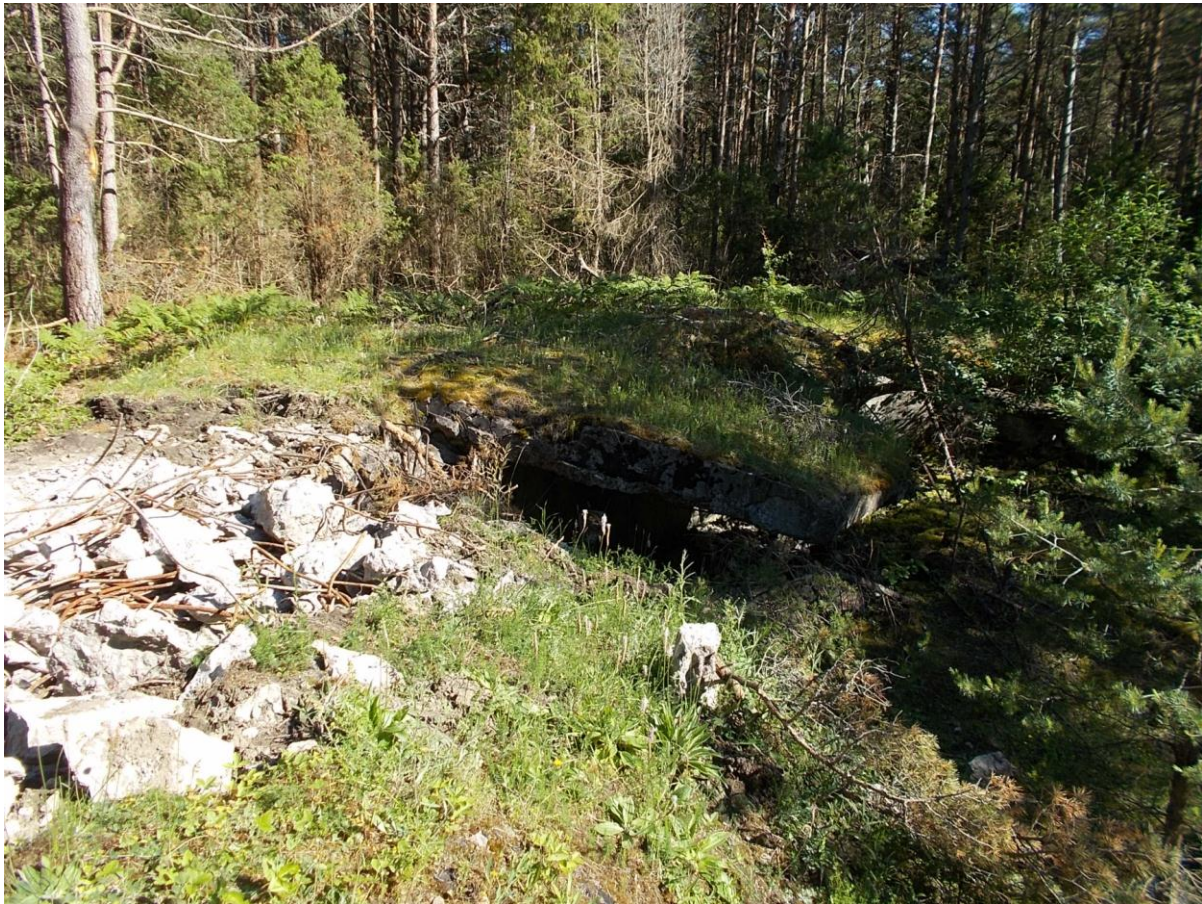
Foto 7. Suurtükibloki nr 4 allavajunud ringlagi. Vasakul betoonlae tükkidest väljapurustatud armatuur. Foto Jüri Pärn 28.06.2015.
