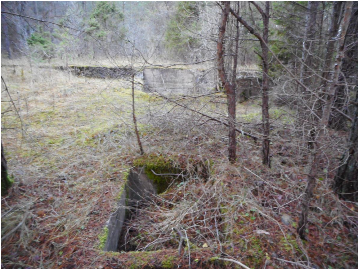
Foto 11. Jõujaama drenaažišaht riisktrapiga (prahti täis), taamal tehnoloogiline šaht. Foto Jüri Pärn 6.12.2017.
