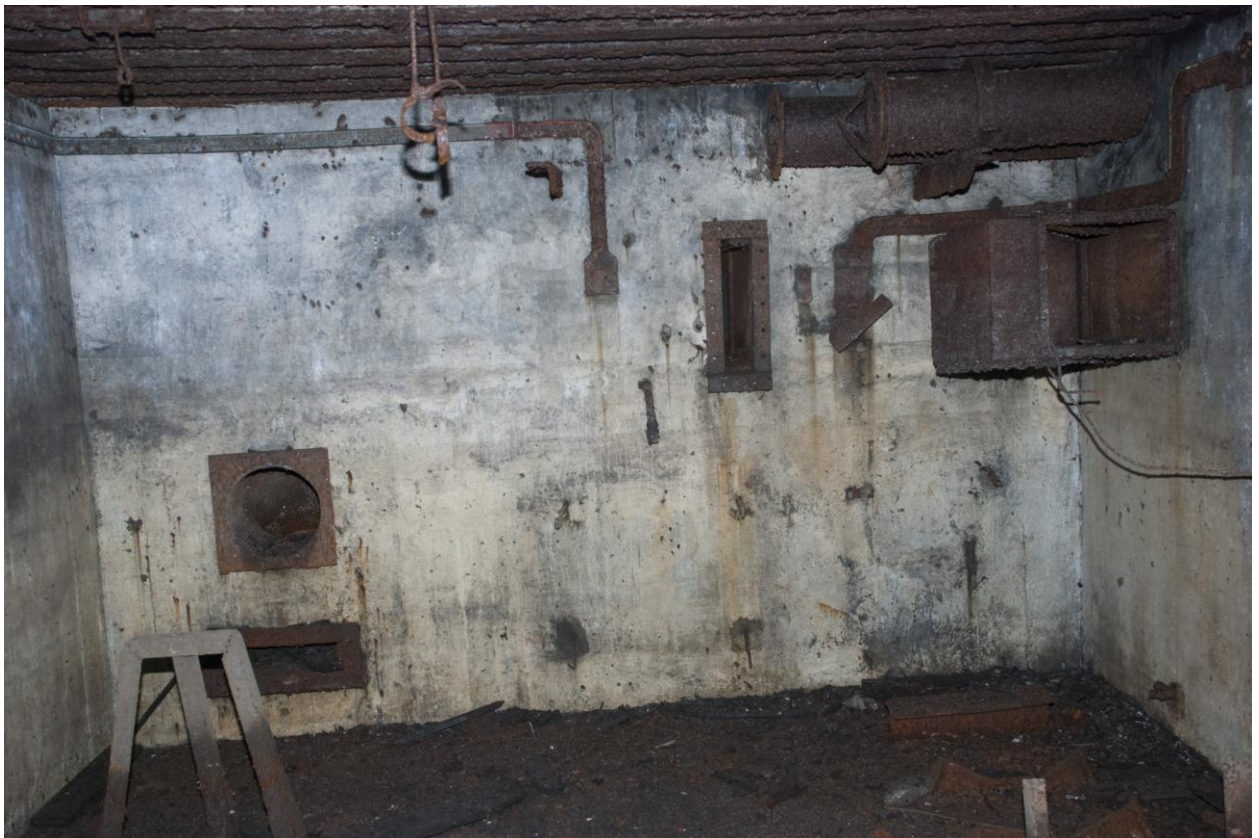
Foto 26. Jõujaama sisevaade (katlaruum?). Foto Mart Mõniste 29.09.2012.
