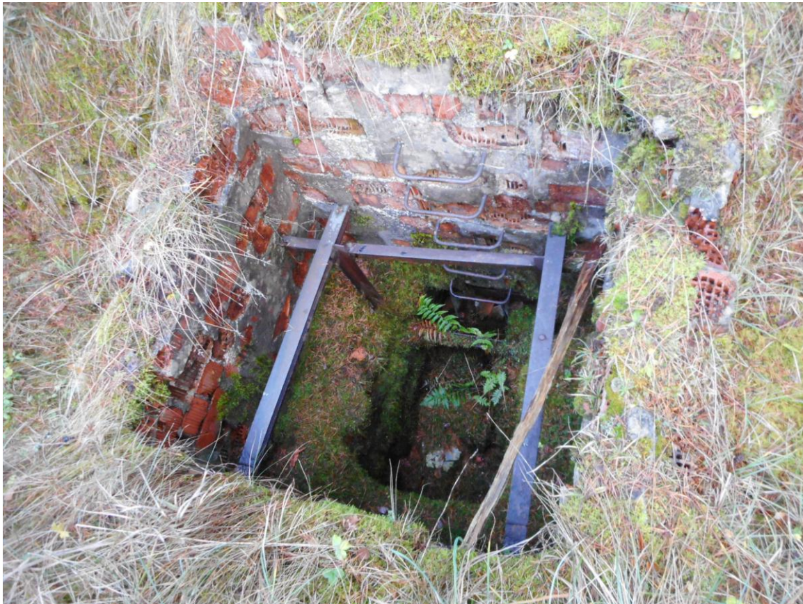
Foto 9. Jõujaama ventilatsiooni? šaht riisktrapiga. Foto Jüri Pärn 6.12.2017.
