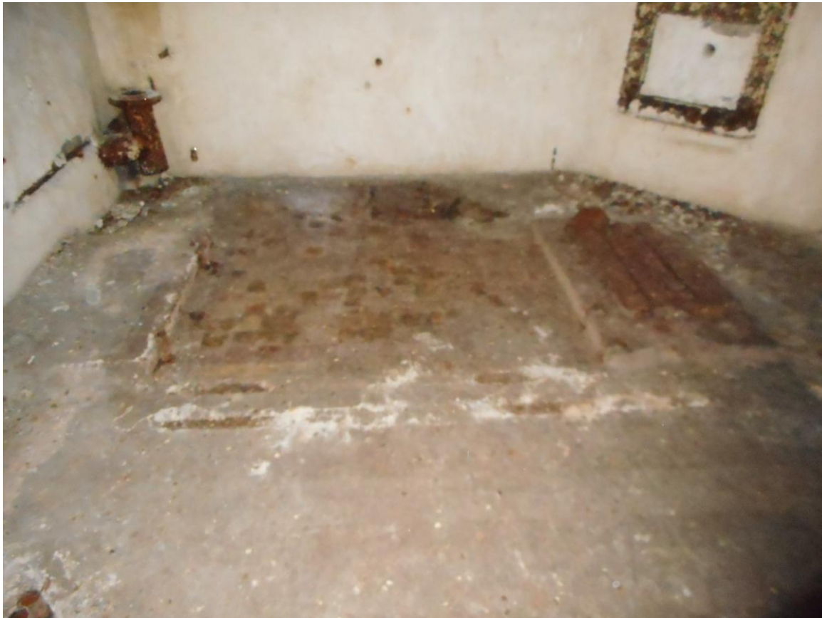
Foto 18. Komandoposti [65] masinaruumi tagaosas on kõrvuti 2 madalat betoonalust, mille vahel on põrand kaetud keraamiliste plaatidega. Kolmas alus paistab foto vasakus allnurgas. Paremalt suletud lõõriava. Foto Jüri Pärn 6.12.2017.
