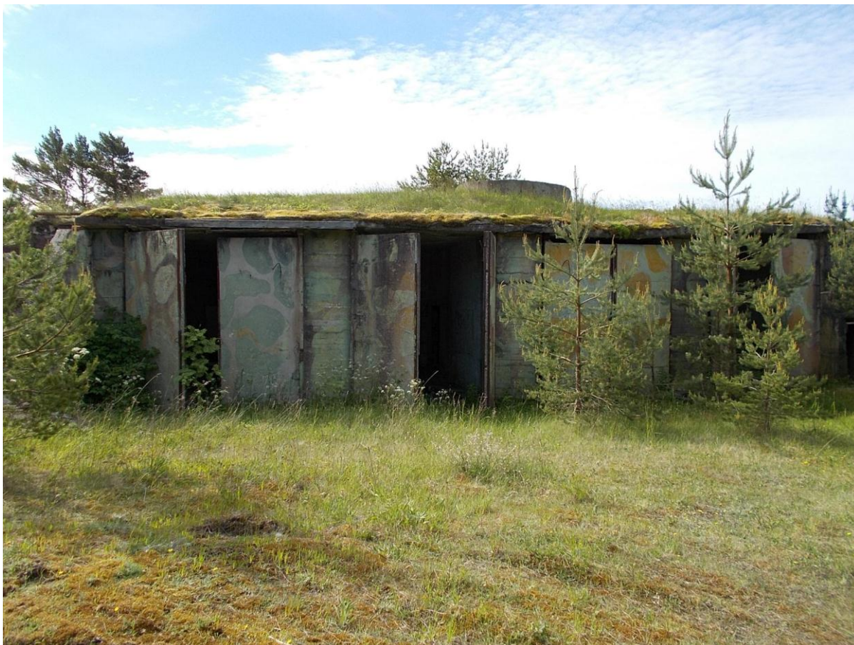
Foto 28. Divisjoni komandopunkt [66], vaade põhjast. Neljas boksis asusid (vasakult paremale) kaks diiselektrijaama ESD-100 (5Je96), teisaldatav trafoalajaam PTP-180 (5Je74), side- ja ühenduskabiin 5F20 (KUNG järelhaagisel) ning jaotuskabiin (RKU) ja. Foto Jüri Pärn 10.06.2015.
