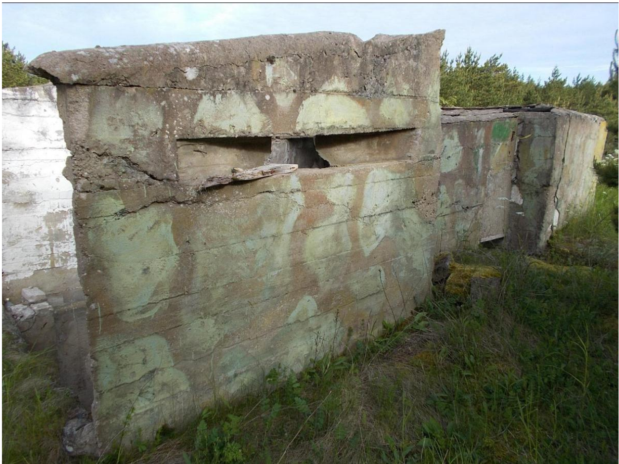
Foto 32. Tagaranna seniitraketidivisjon. Komandopunkti [66] dott. Selle lõunapoolne sein ja lõunapoolse osa katus on kokku varisenud. Foto Jüri Pärn 10.06.2015.
