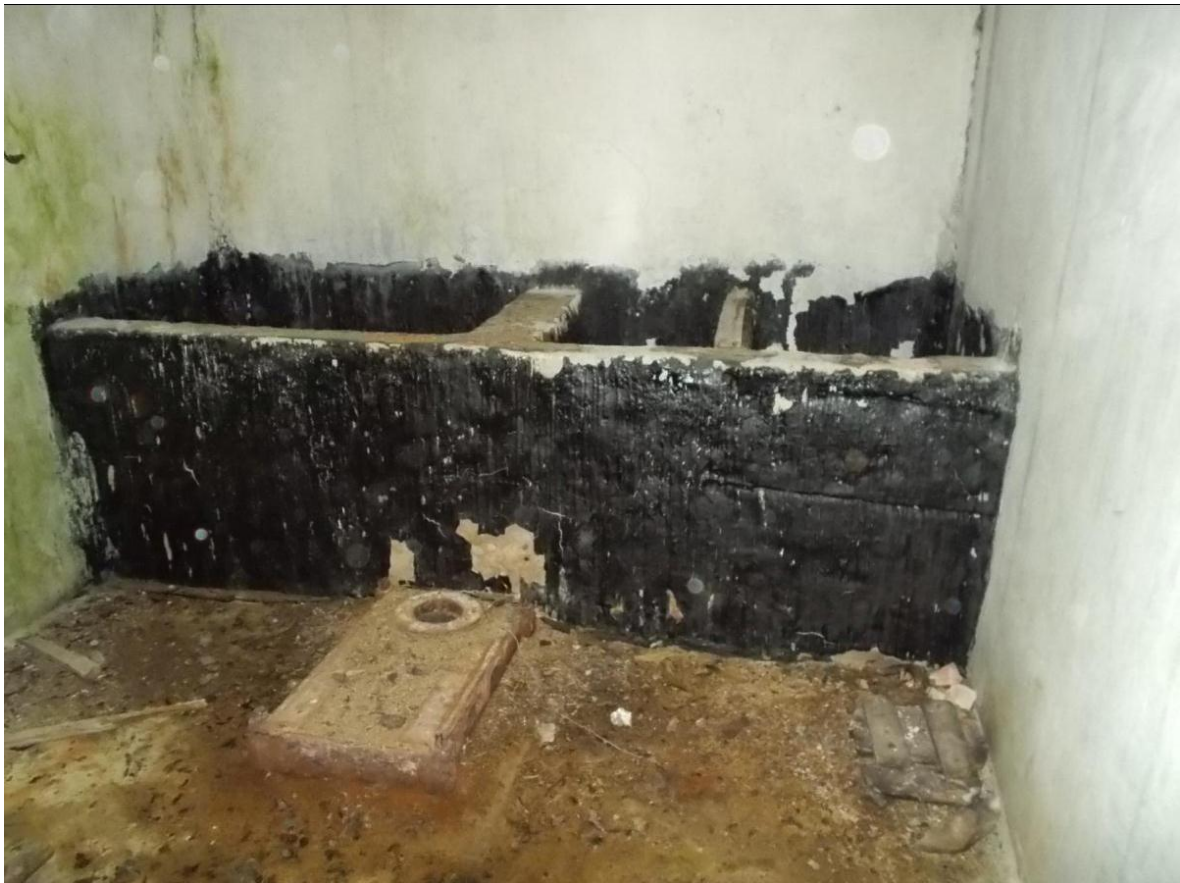
Foto 55. Ninase 180 mm rannapatarei. Punkris [47] on bituumeniga? seest ja väljast ülemaalitud betoonkast ja maasse suunduva toruga pumba?alus. Foto Jüri Pärn 27.06.2015.
