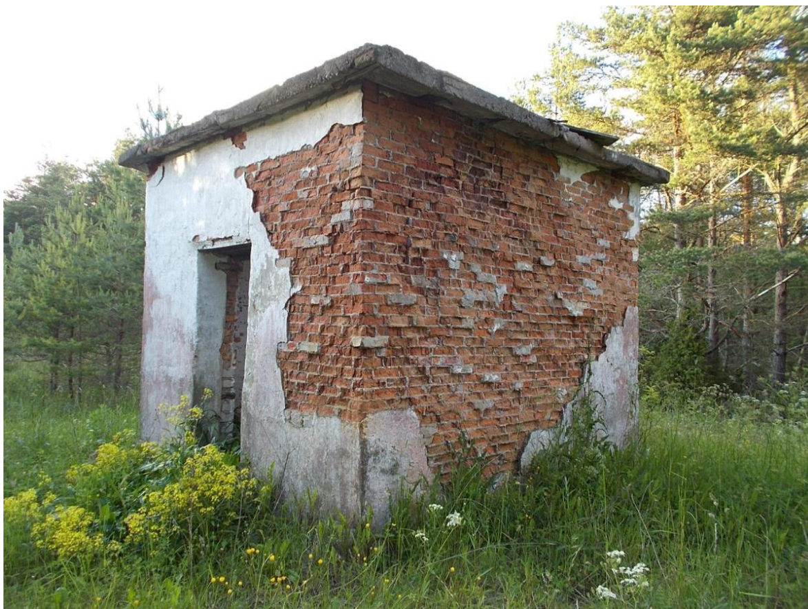
Foto 59. Pumbamaja [3] tamponeeritud puurkaevuga. Foto Jüri Pärn 27.06.2015.
