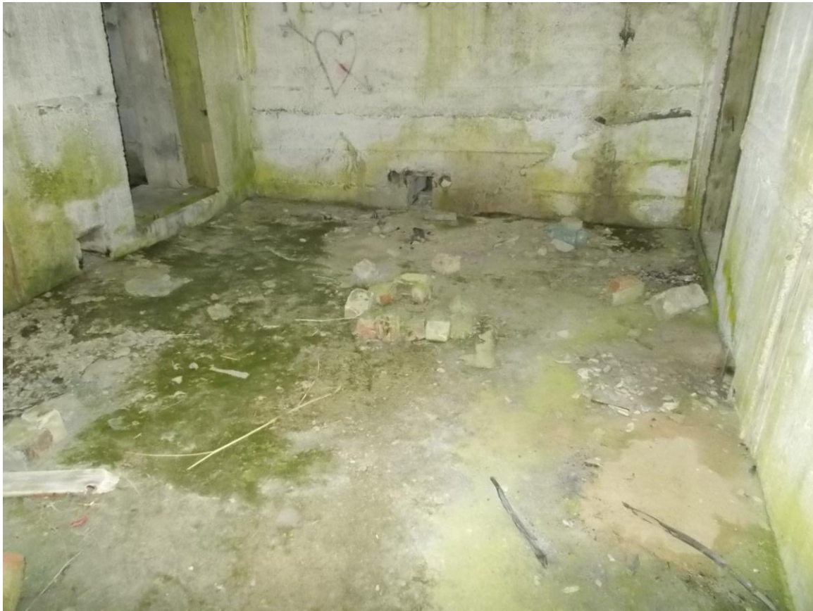
Foto 37. Komandopunkti [66] liikuva trafoalajaama PTP-180 boksi tagaosa. Kolmes seinas on põranda lähedal kaabliavad. Foto Jüri Pärn 10.06.2015.
