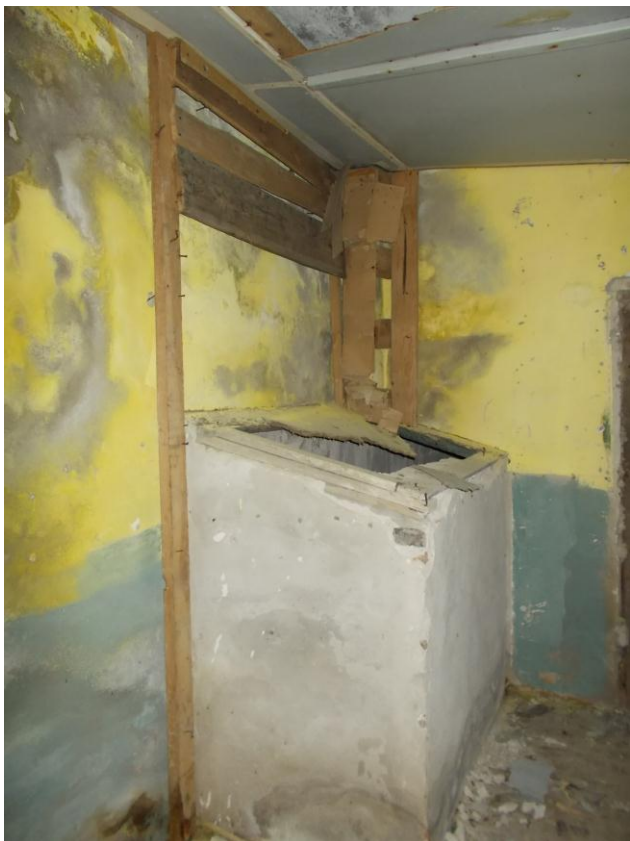
Foto 45. Komandopunkti [66] köige viimistletum ruum. See betoonkast varjab läbipääsu pikast boksist koridori. Foto Jüri Pärn 10.06.2015.
